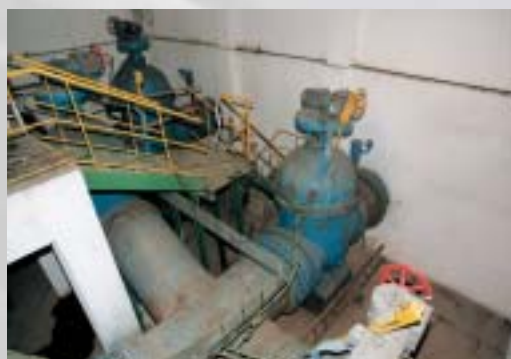
Armaturní objekt před rekonstrukcí káranského páteřního řadu, 12/2000 - 3/2001
