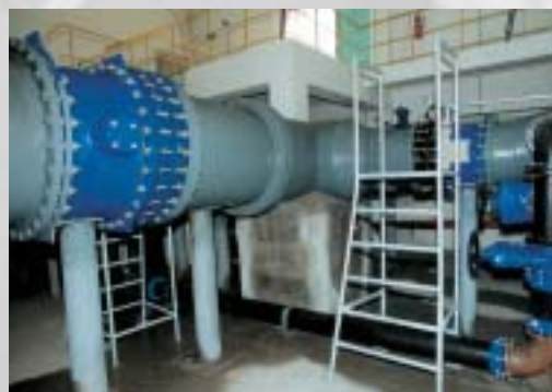
Armaturní objekt po rekonstrukci káranského páteřního řadu, 12/2000 - 3/2001
