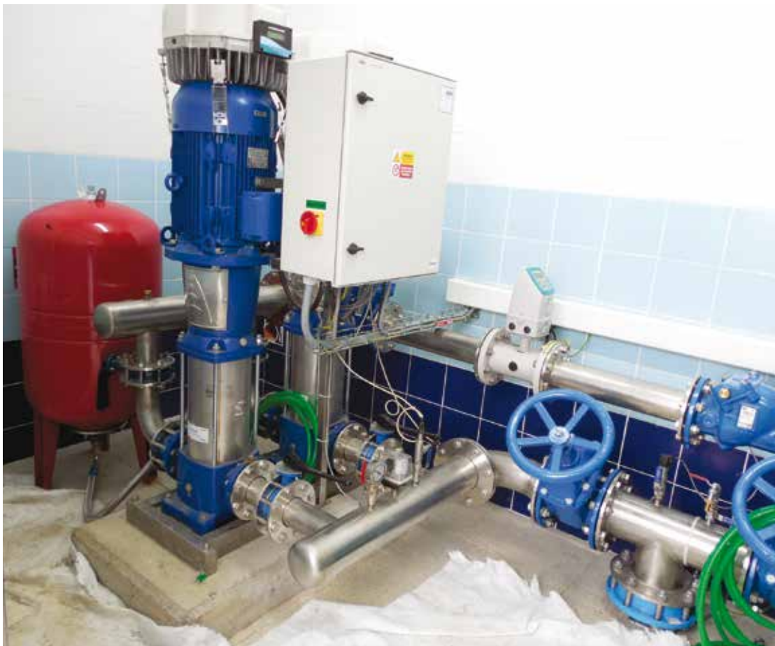
▲ Vystrojení čerp. stanice pitné vody pro Dobrovice
