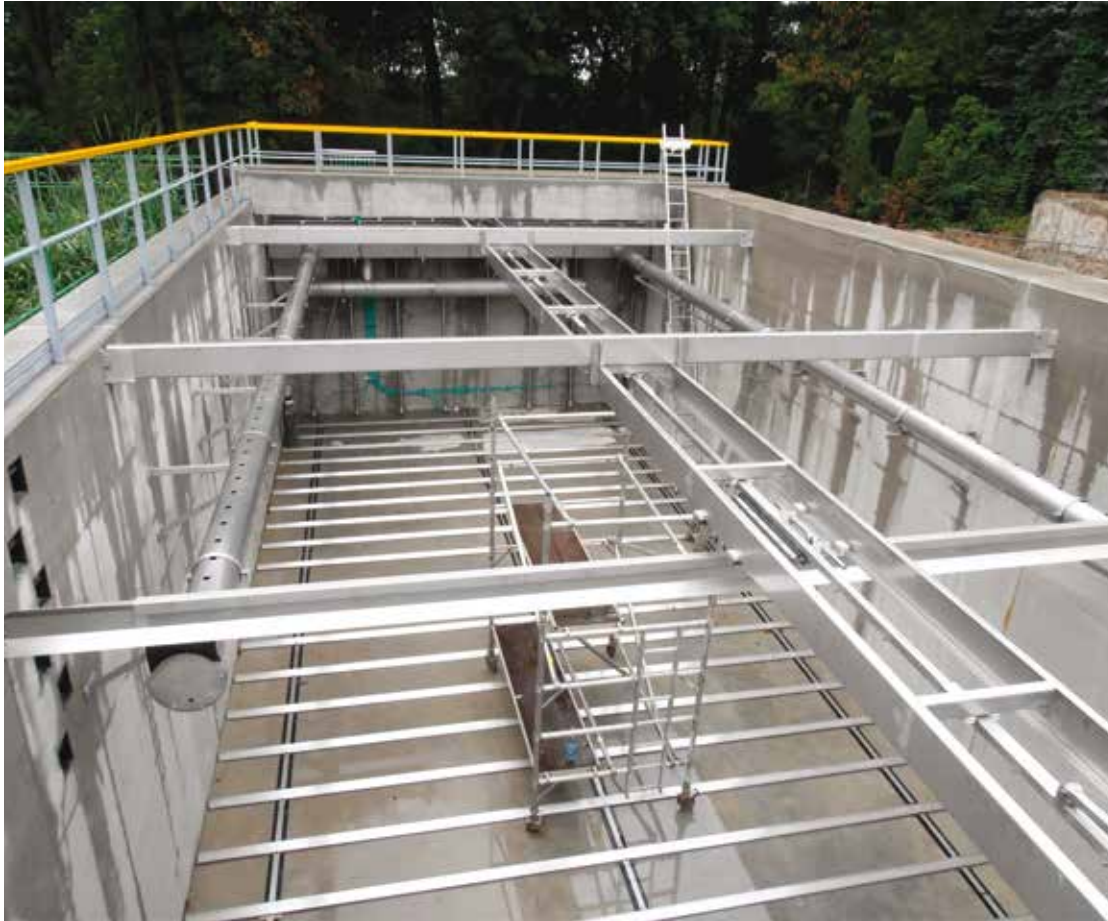
▲ Mnich. Hradiště, ČOV, dosazovací nádrž
