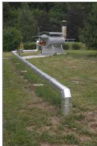
▲ Hořák zbytkového plynu na ČOV II Mladá Boleslav - Podlázky
