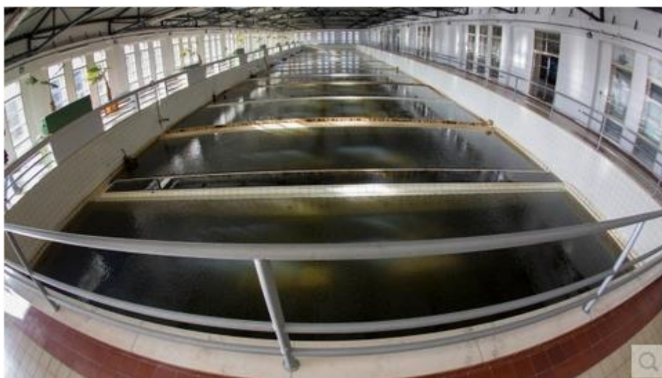
Drahá voda: Více než 120 milionů korun investovaly do čističky ve Vítkově-Podhradí Severomoravské vodovody a kanalizace. autor: ČTK
